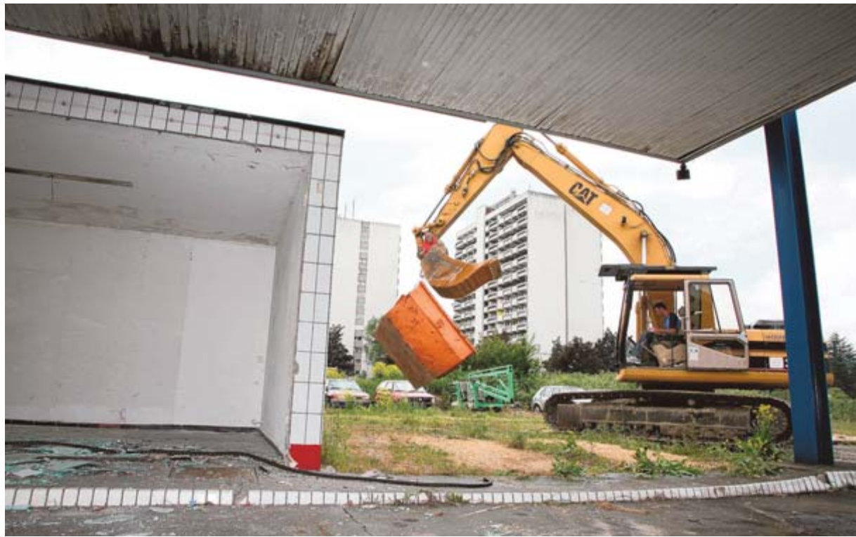
An der alten Tankstelle: Die Abräumarbeit auf dem Berliner Platz hat begonnen, der Gemeinderat hat den Weg für die Ansiedlung eines Supermarkts frei gemacht.
